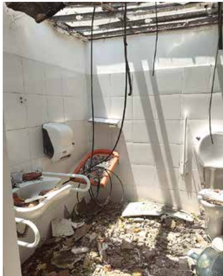
Lo que fue. Así quedó uno de los baños que funcionaba en la subse comunal.
